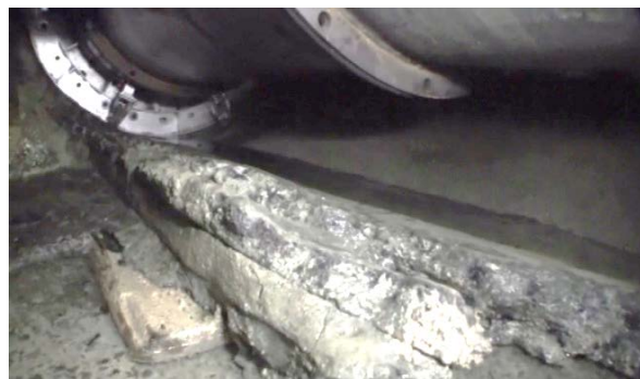
⑧人孔内は完全に止水 された状態になります
