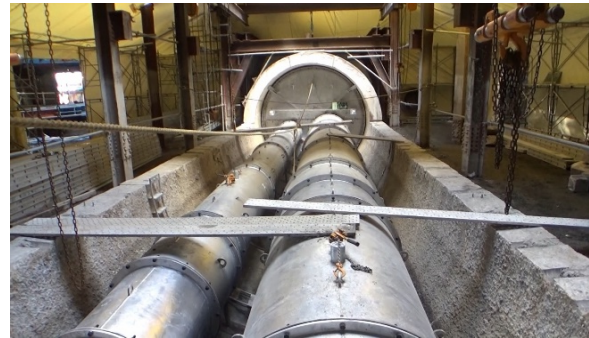
【手順24】 以上で第1回目の作業は完了。 次は、新設迂回路構造物の構築を行い流路変更工事を行う。
